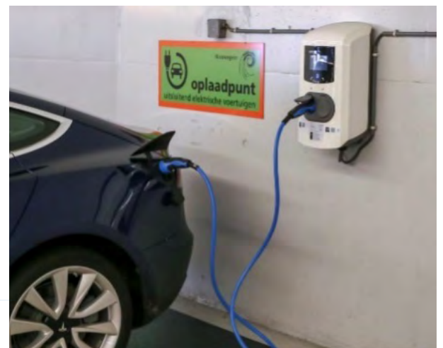
Fig. 9 : Installation de charge dans un parking souterrain
